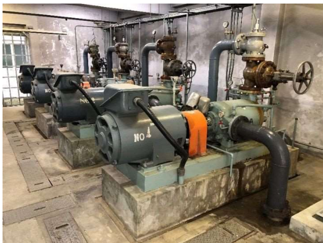
御塩井ポンプ場（送水ポンプ）
