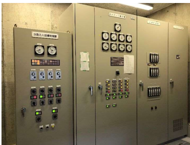
送水ポンプ制御盤
