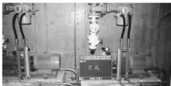
向山簡水送水ポンプ施設
