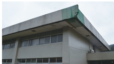
外壁が脱落した屋根
