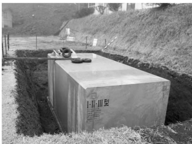
これで安心ばい（防火水槽・五ヶ村地区）
