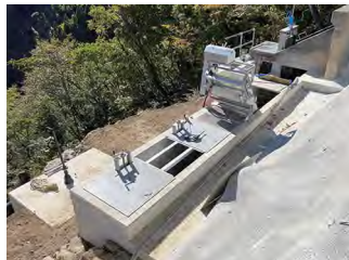
発電所ヘッドタンク付近
