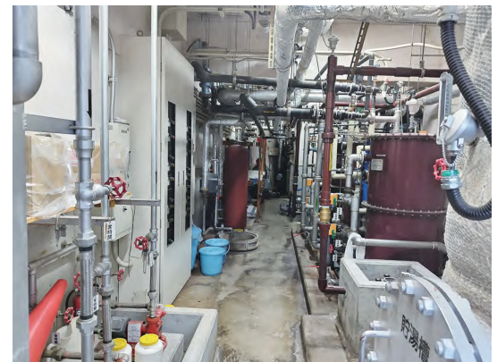
天岩戸の湯のポイラー室
