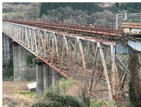
修理と塗り替えが必要とされる高千穂鉄橋
