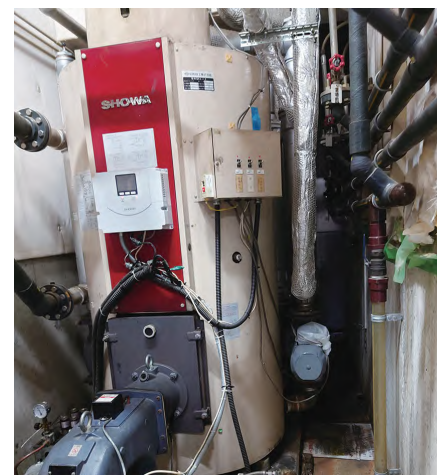
更新予定の天岩戸の湯現ボイラー設備
