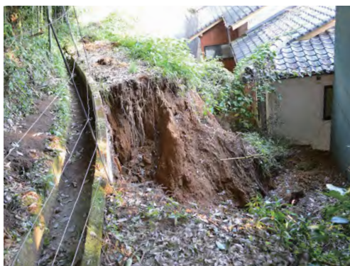
不落となった令和4年度の災害現場(岩戸・黒原地区)
