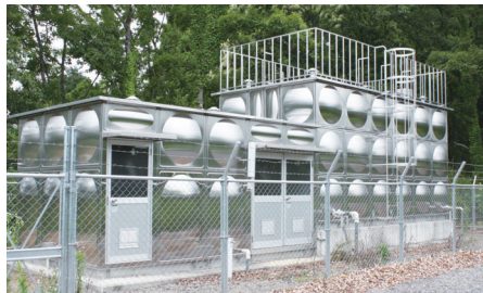
新設された配水施設
