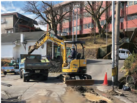
水道管の老朽化で漏水が増加（写真は役場下）。計画的な管路更新に取り組む必要があります。
