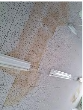
雨漏りする天井
