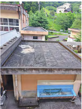
雨漏りする屋根
