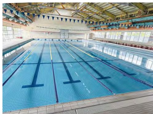
老朽化が進む温水プール
