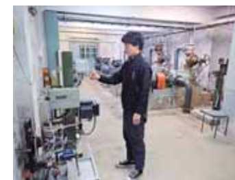
上水道浄水場
