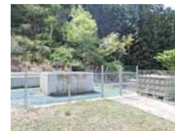
簡易水道施設
