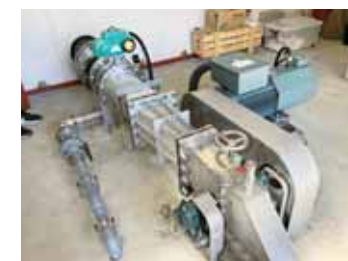
クロスフロー水車（発電機）
