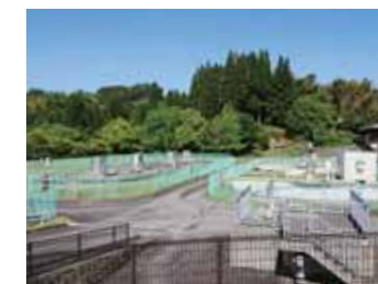
下水道処理施設
