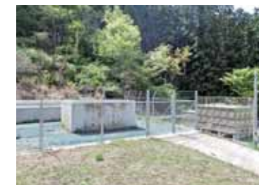
簡易水道施設
