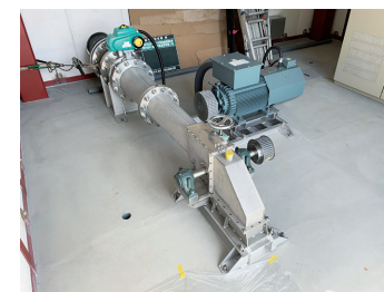
クロスフロー水車（発電機）
