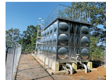
営農飲雑用水施設（配水池）
