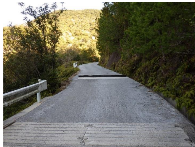
工事状況 (鉄鋼スラグ路盤工、コンクリート路面工、木製横断工)
